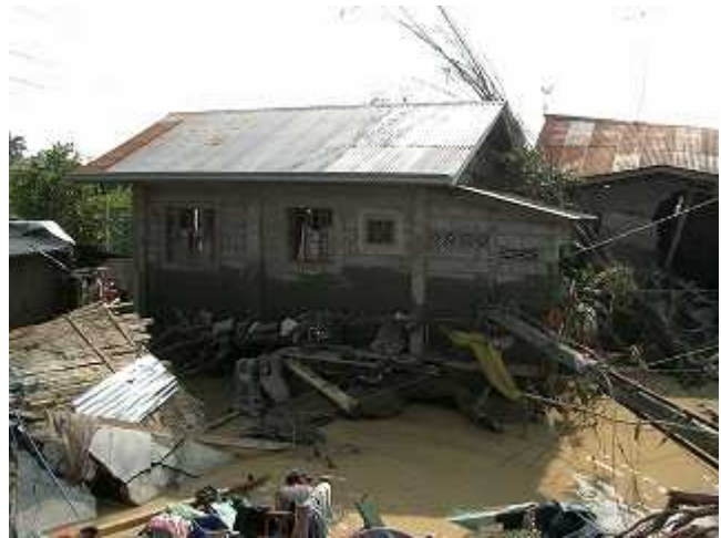
写真：アグノ川の破堤による被害
